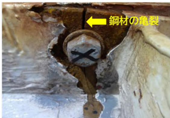
①伸縮装置の腐食状況（路面裏側）
