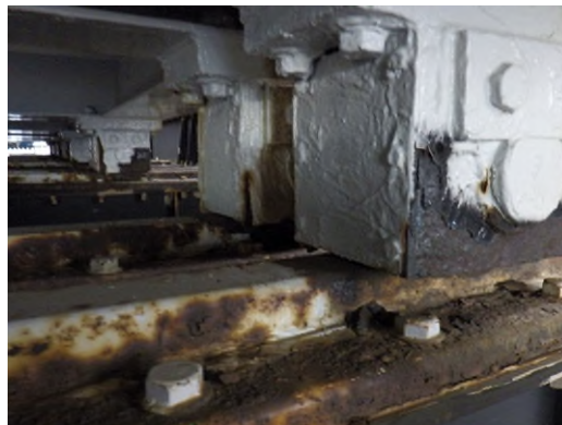
②大型伸縮装置の腐食状況
